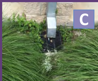
Bajante desviado hacia una cuneta mediante la cuenca de captación y la tubería subterránea.
