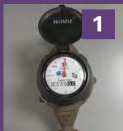
Medidor de agua
